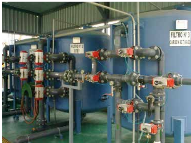
Sistema de automatización de los tanques de filtración.
