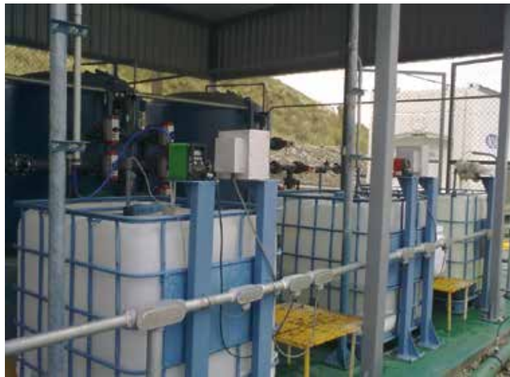
Automatización de dosificación de reactivos para el proceso de purificación de agua.
